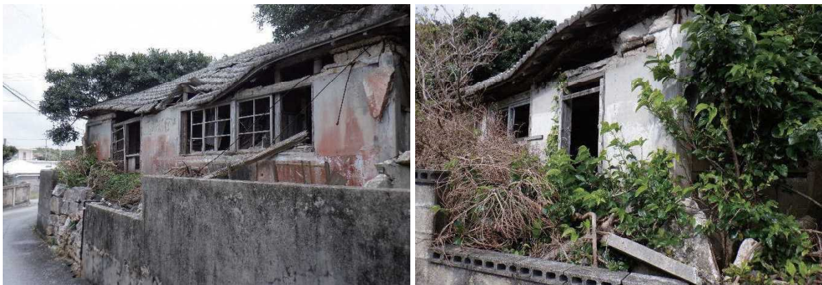
危険な空き家
