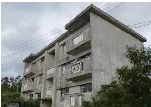
老朽化した公営住宅
