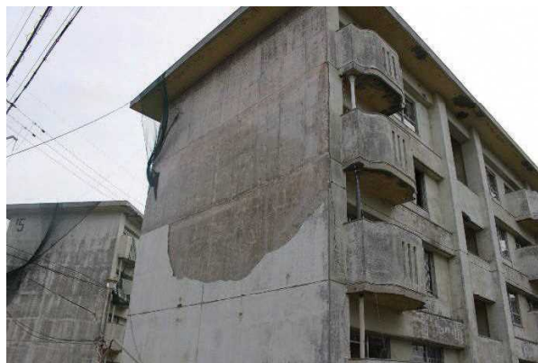
平成 30 年 7 月に発生した台風 8 号の被害
